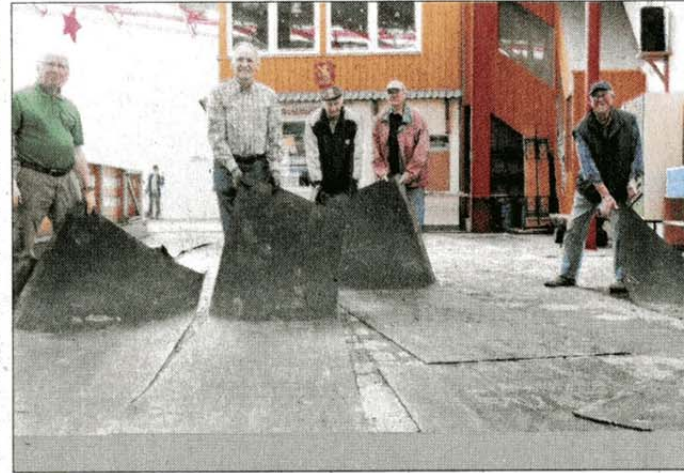
Die Mitglieder des „Bauteams“ der „Lauenauer Runde“ haben die alten Matten bereits beseitigt.
